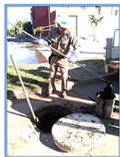
Acumulación de sedimentos en el colector principal
