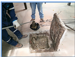
Vertido de grasas en la red de alcantarillado que ocasiona la obstrucción en cámaras y colectores
